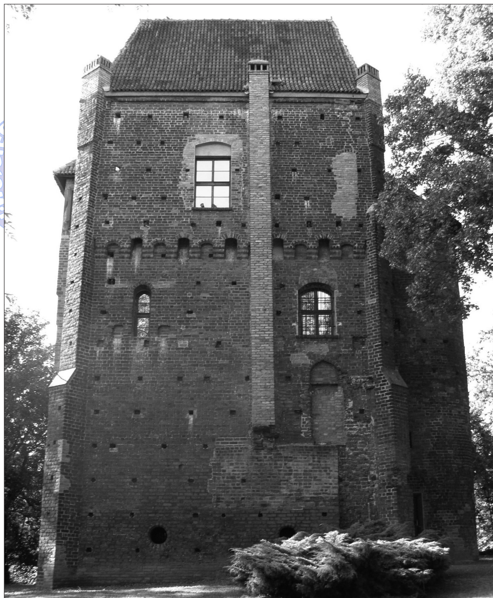
Ryc. 3. Tzw. Baszta Halszki w Szamotułach, elewacja wschodnia, stan z 2009 r. Fot. autor.
